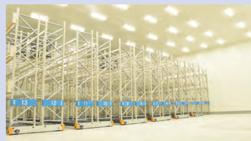
▶冷凍・冷蔵倉庫内 電動式パレットラック(ノンレール式)
